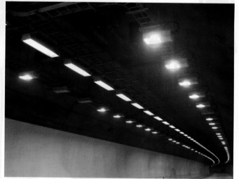
在雪山隧道的洞口段輔以高壓鈉燈以加強照明
