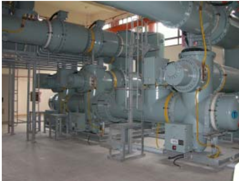
圖 2.5 坪林 161kV 特高壓 GIS 開關設備
