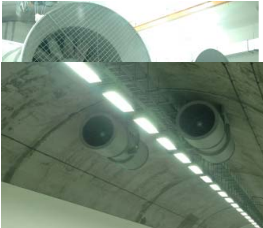
圖 4.5 雪山隧道噴流式風機 直徑 1 公尺
