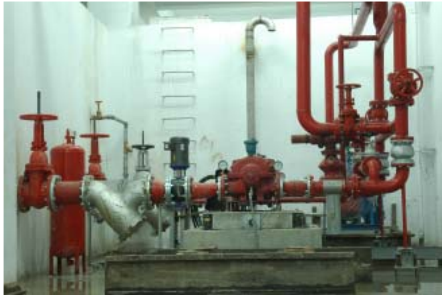
圖 6.2 雪山隧道消防泵
