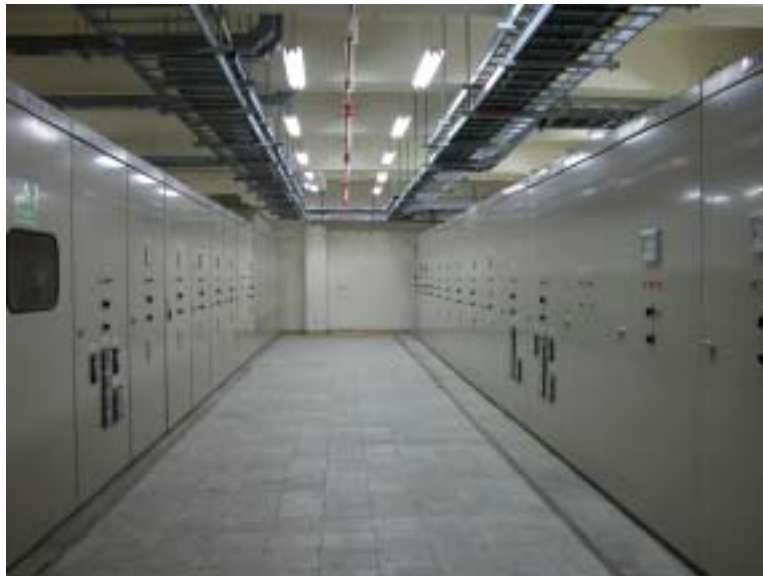
圖 2.1 坪林特高壓變電站 22.8kV 高壓配電盤
