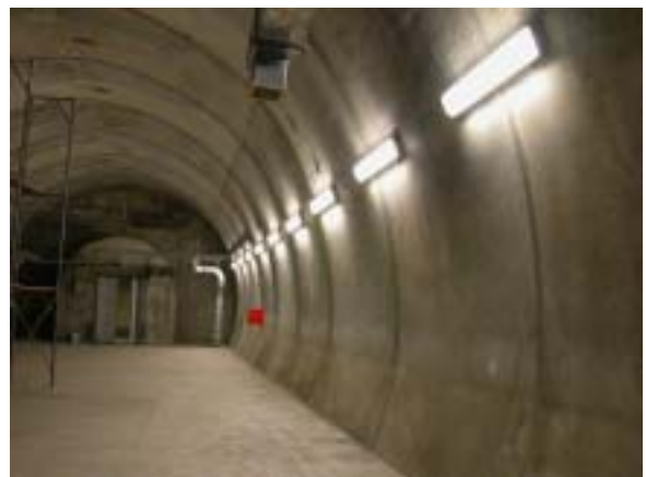
圖 3.6 人行聯絡隧道照明
