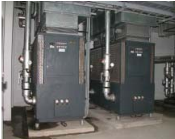
圖 4.6 氣冷式冰水主機（製造冰水）
