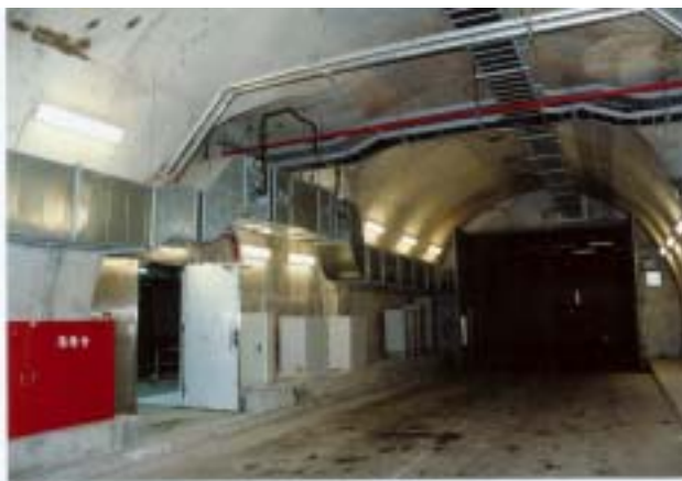
圖 3.5 車行聯絡隧道照明
