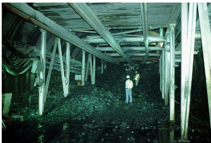
圖 22 北上線里程 38K+902.5 TBM 抽坍情況
