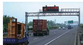
資訊可變標誌 | Changeable Message Sign
