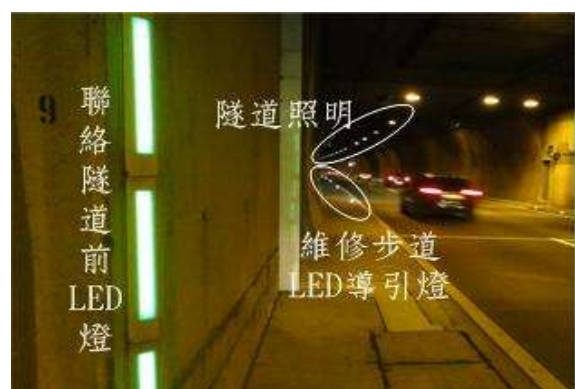
隧道內照明設施
