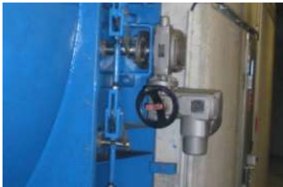
軸流風機進排氣閘門控制動力裝置
