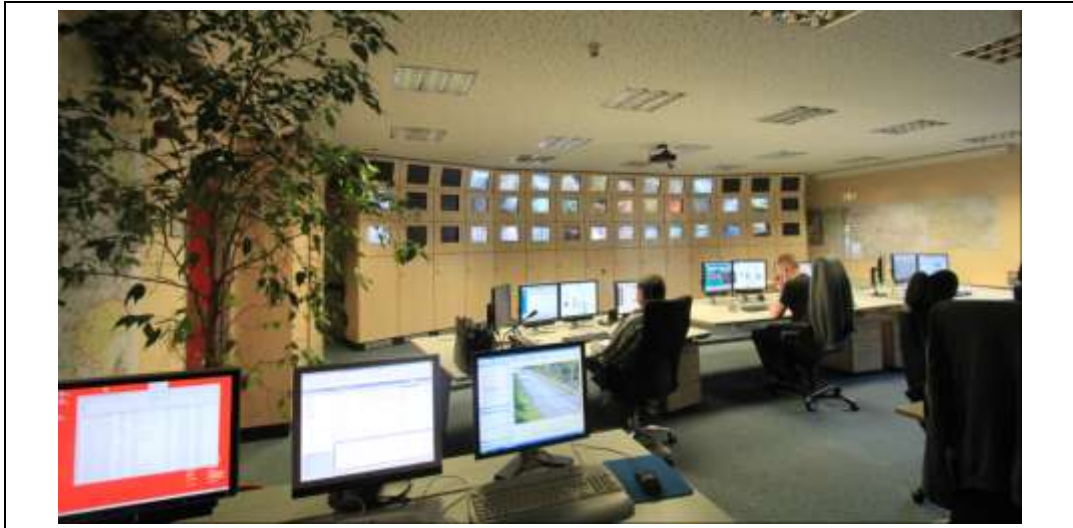
圖3.1.4 Thuringia控制中心控制室
