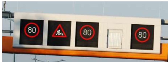
多功能型資訊顯示設備
