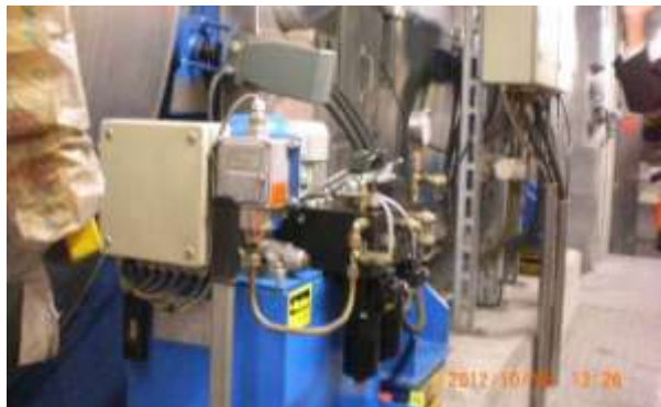
軸流風機進排氣閘門控制動力裝置
