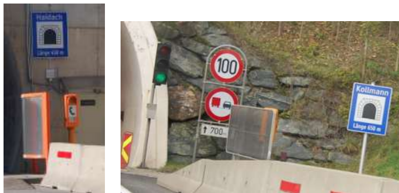
隧道口緊急電話
