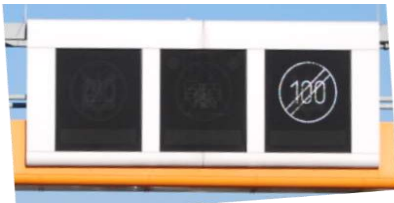
可變式解除速限標誌
