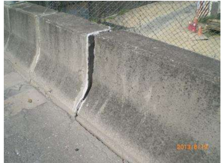
國道1號北上328K+750處 外側紐澤西護欄外傾開 裂
