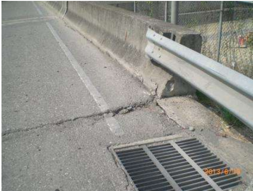
國道1號北上328K+750處 第4車道及外路肩路面下 陷開裂
