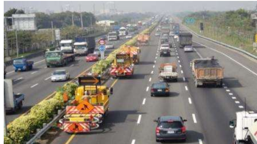
清掃車後方緩撞設施及警示標誌
