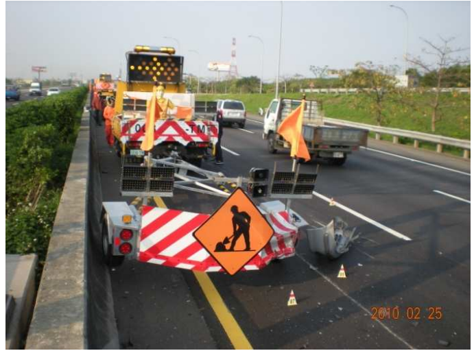
緩撞設施結合移動性施工警示車作業時事故現場
