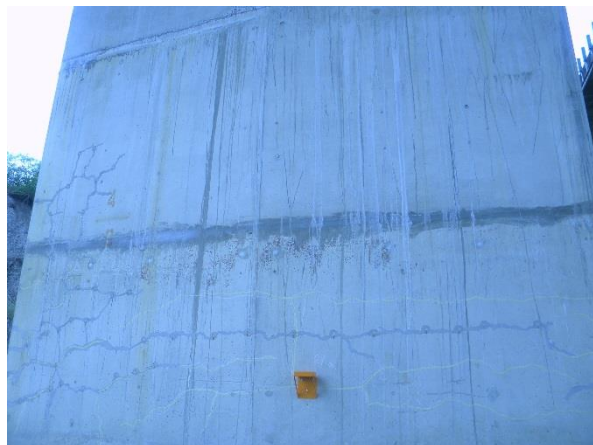
北側橋墩底部發生橫向裂縫
