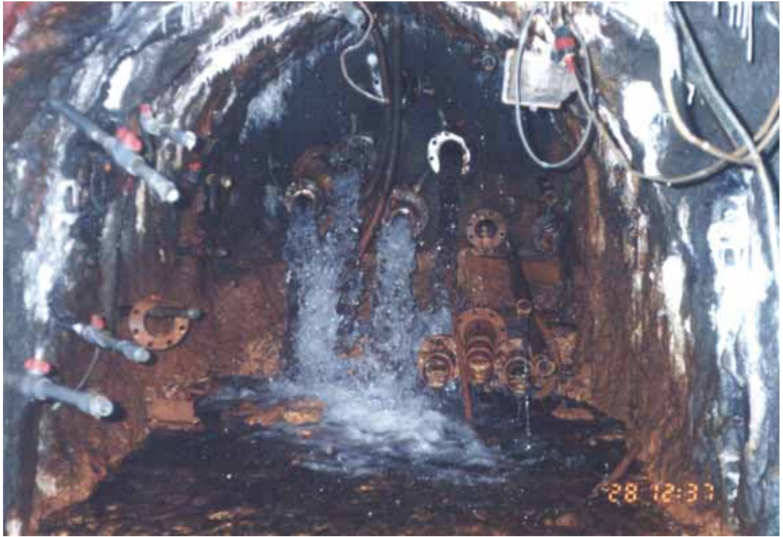
照片二、導坑第十次受困 A 坑出水
