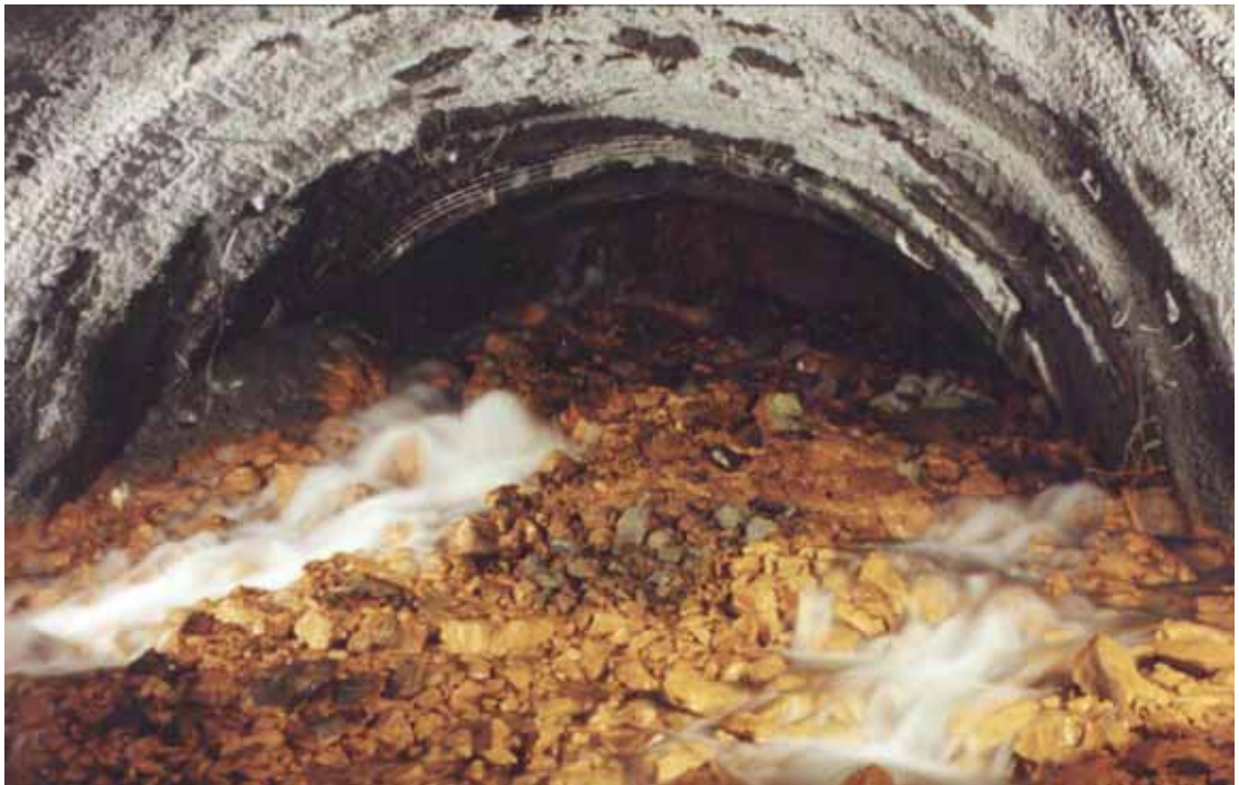
照片一、導坑里程 38K+935 湧水抽坍
