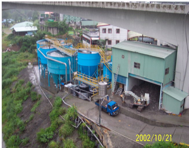
圖 5 (2) 北宜高速公路雪山隧道北口（坪林）廢水處理新增設施全景、脫水機房
