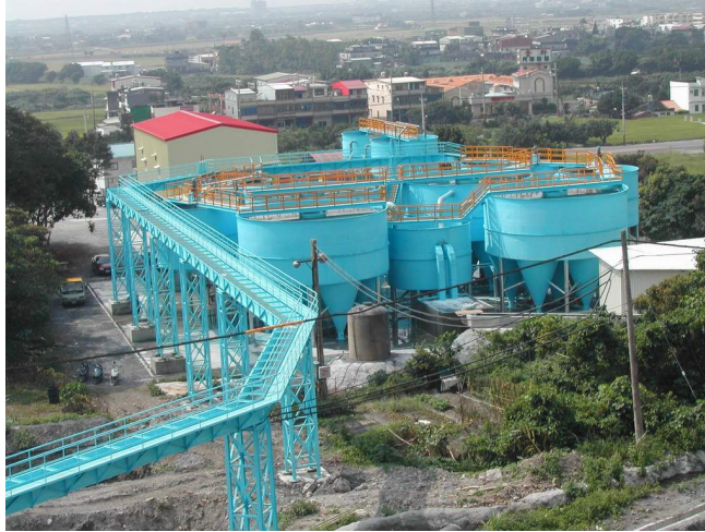
圖 5 (1) 北宜高速公路雪山隧道南口（頭城）廢水處理設施
