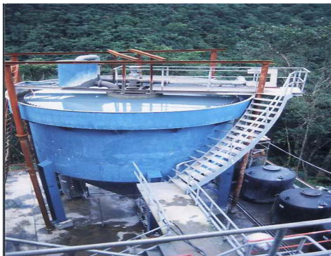
圖 5 (3) 雪山隧道三號豎井廢水處理設施高架式混凝沉澱池、新增初沉池
