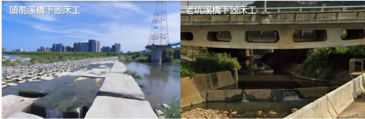
圖附 1.2-15 水域廊道改善需求高(左)及需求中等(右)之橋梁附屬構造物
