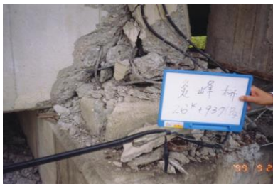
炎峰橋主梁破壞
