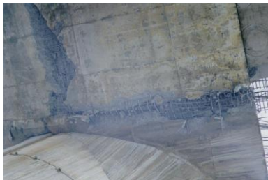
集鹿大橋主橋面版破壞
