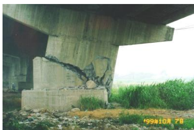
烏溪橋剪力破壞
