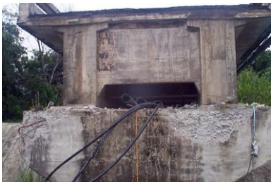
龍門大橋落橋（無防落裝置）
