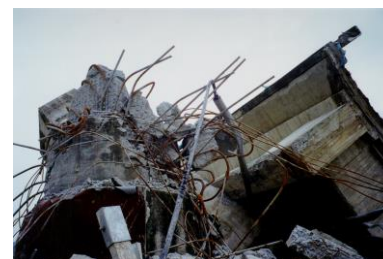
桶頭橋橋柱撓剪破壞
