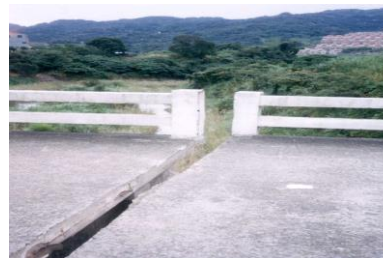
光龍橋主梁移位破壞
