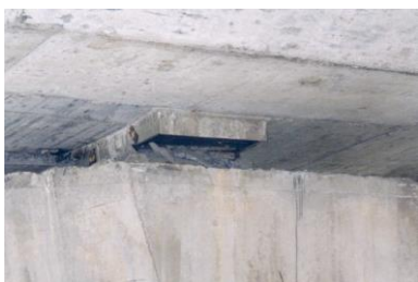
新溪南橋支承破壞
