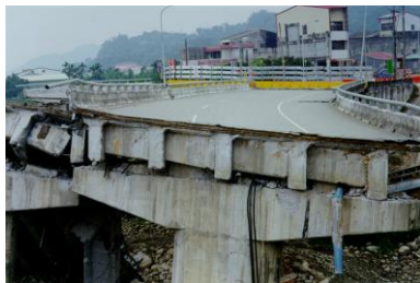
石園橋止震塊破壞
