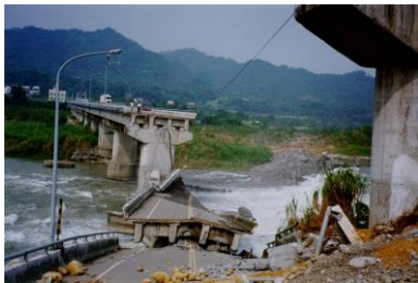
埤豐橋落橋（斷層通過）
