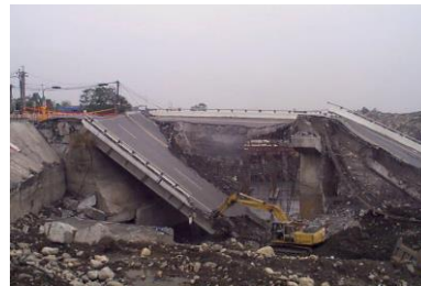
名竹橋落橋（斷層通過）
