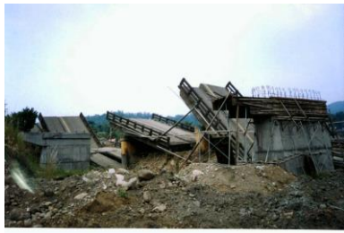
一江橋落橋（斷層通過）
