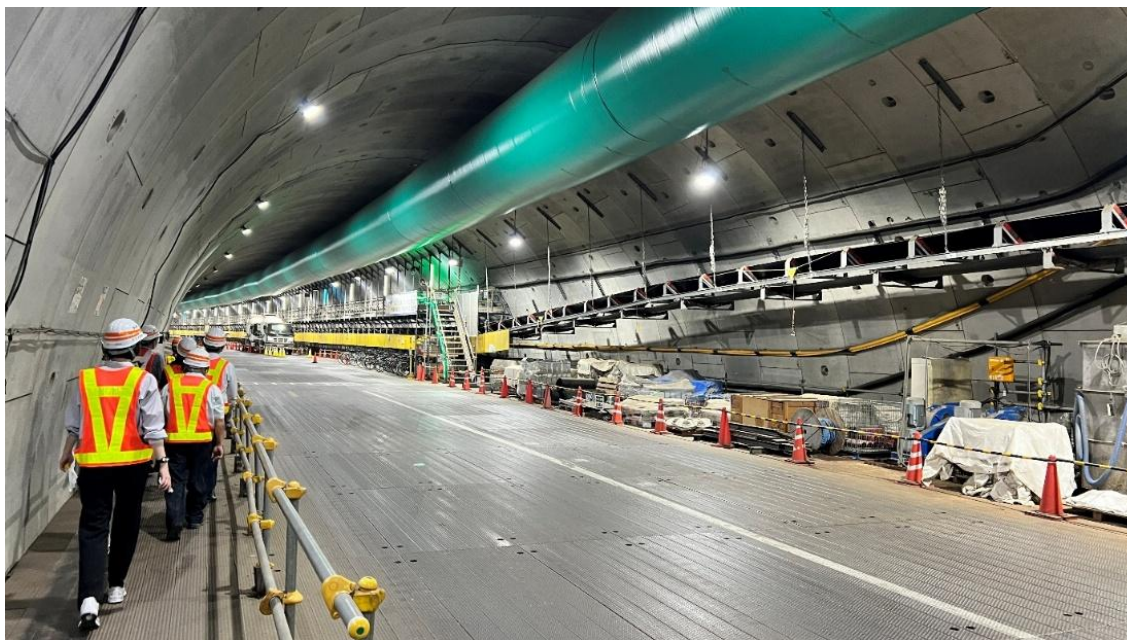
圖4-9 坑內通風設備及人車分道環境
