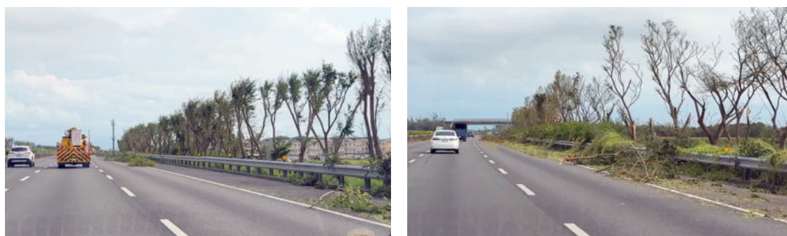
圖 3.15 新營工務段印度紫檀降剪作業成果對比 (左圖) 風災時降剪路段 (278k + 713 至 279k + 197) 未出現傾斜或倒伏 (右圖) 風災時未降剪路段 (277k 至 278k) 受損嚴重
