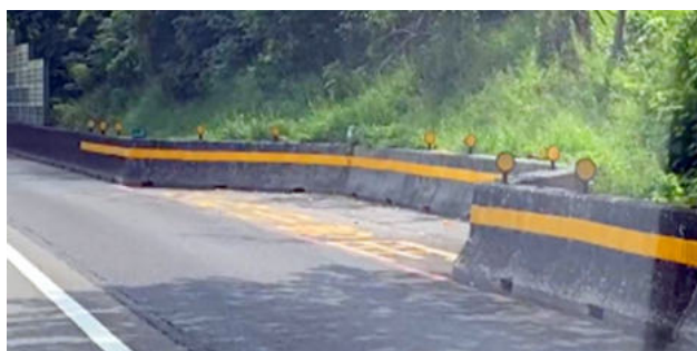
圖 5.24 國道 1 號北向 104.5k 處公務停車彎，設置反光導標及反光浪板
