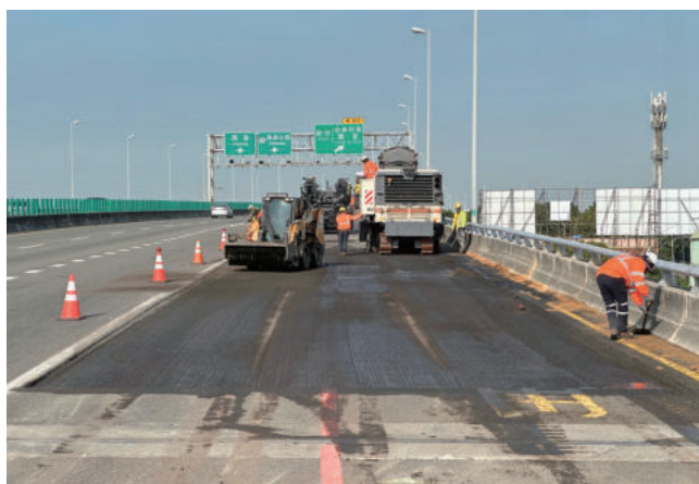
圖 3.12 國道 8 號西向 10.4k 化學槽車翻覆事故甲苯侵害處理
