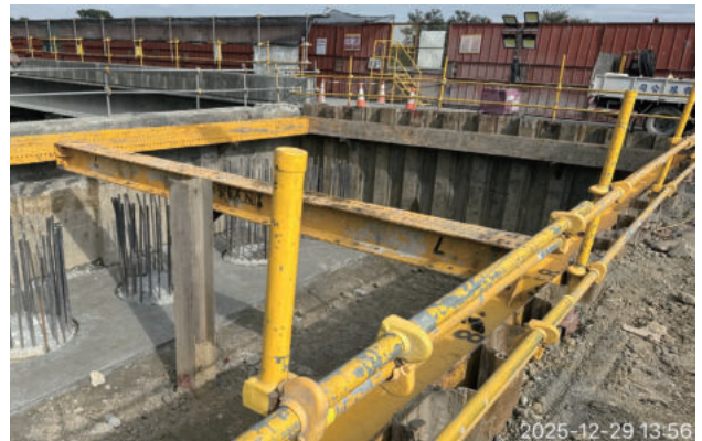
圖 2.53 國道 1 號石龜溪橋改善工程 南下線 A2 橋臺第 1 層擋土支撐組立
