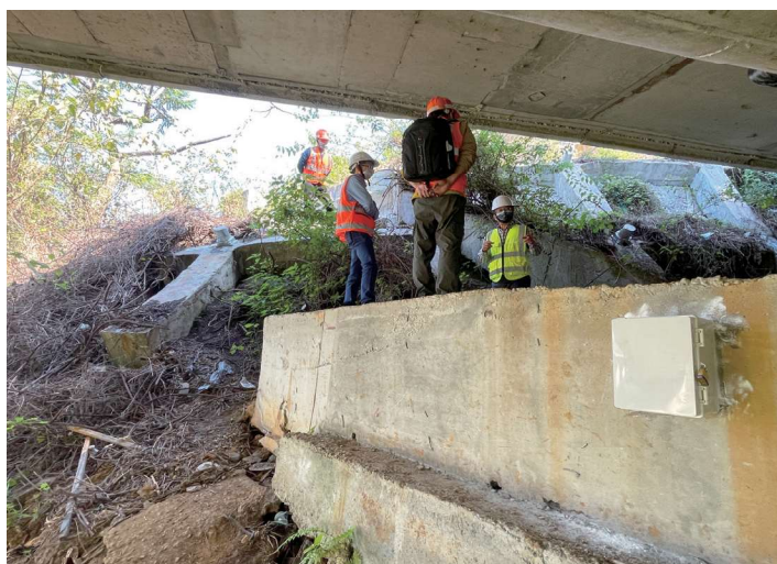
圖 3.11 新設之自動化傾斜計 (TI)
