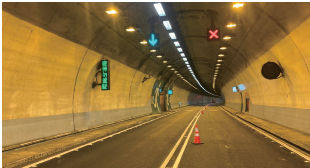
圖 1.3-9 隧道內相關設施
