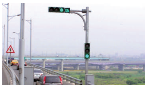
圖 5.1-3 匝道口儀控號誌
