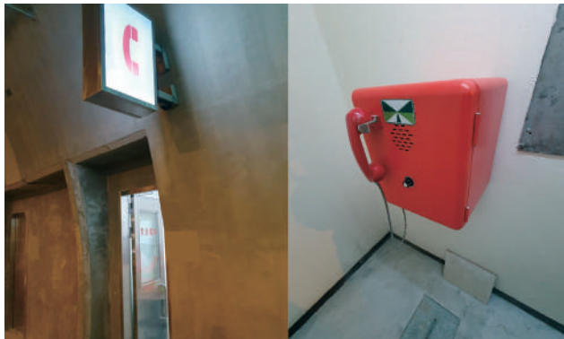
圖 1.3-20 緊急電話 (隧道路側)
