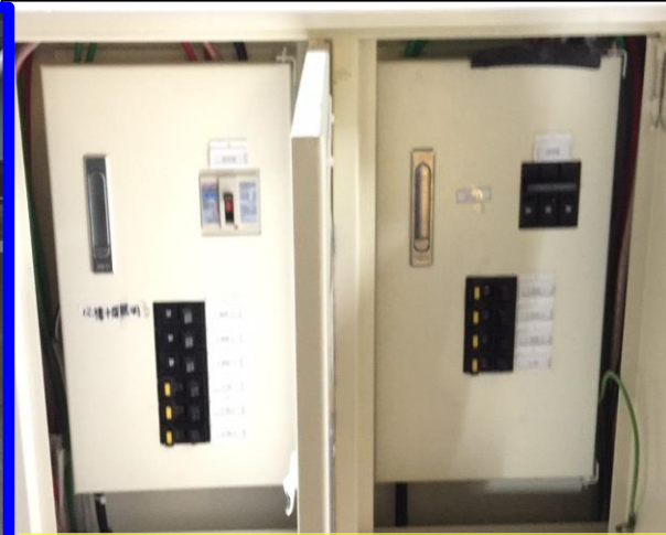
中隔板+漏電斷路器
