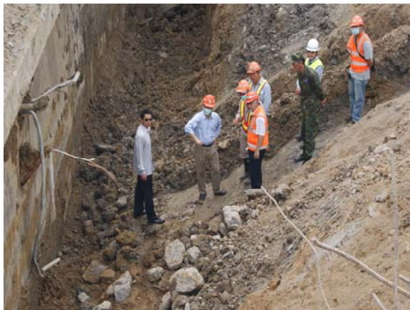
部長視查橋台損壞情形
