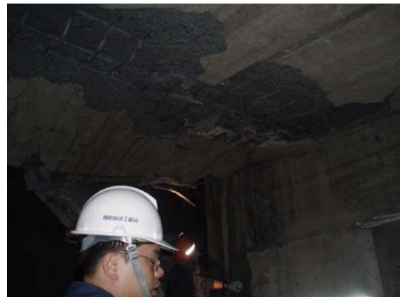
99.04.30. 設施損壞勘查情形(二)
