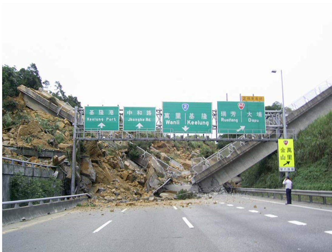
國道 3 號崩塌路段北上線南端(圖一)
