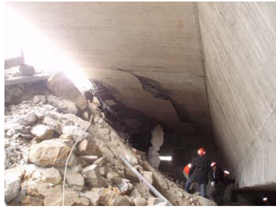
99. 04. 30. 設施損壞勘查情形(四)
