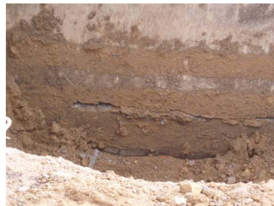
開挖檢視橋台受損情形(二)
