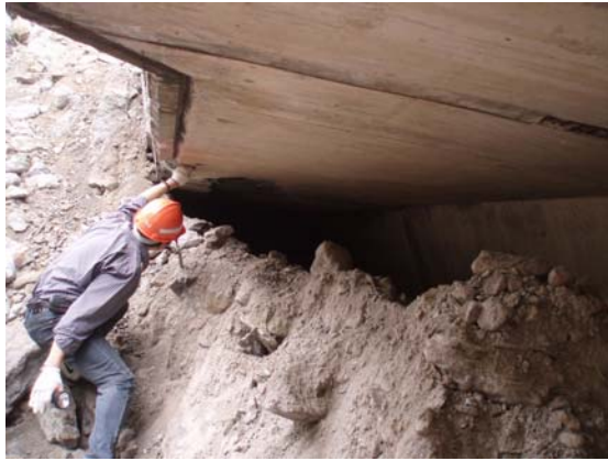
99. 04. 30. 設施損壞勘查情形(三)
