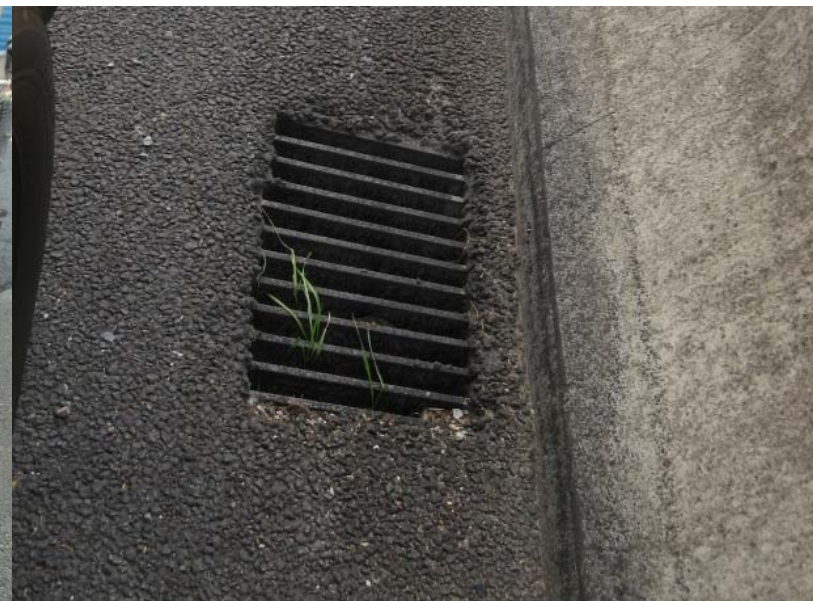
AC封堵 洩水格柵蓋
