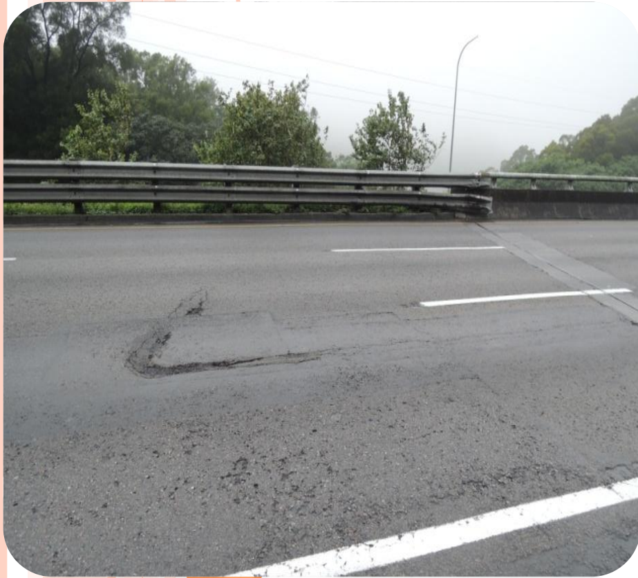
施工前反射裂縫
