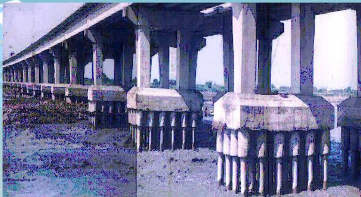
83年7月提姆颱風後中沙大橋橋墩基樁遭沖刷情形
