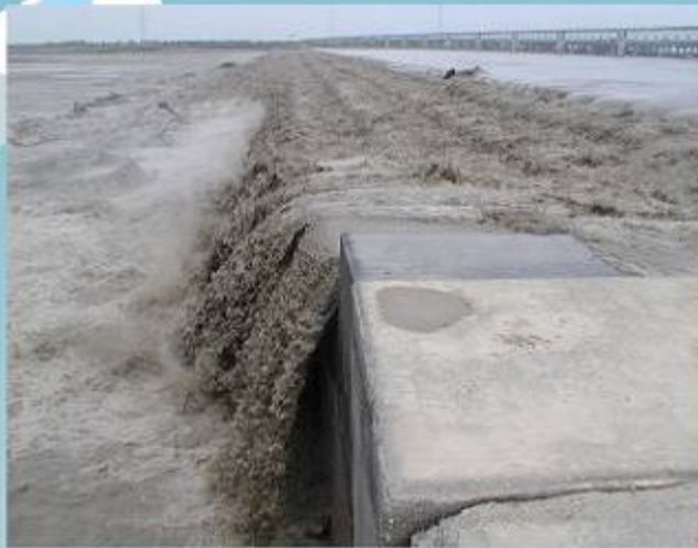
90年納莉颱風造成中沙大橋潛堰下游蜂巢塊沖毀情形
