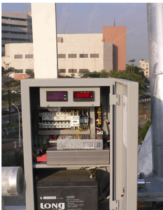
圖4-3系統控制箱設置
