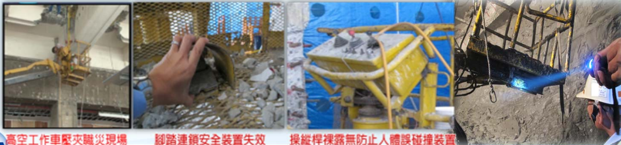
高空工作車壓夾腳災現場
