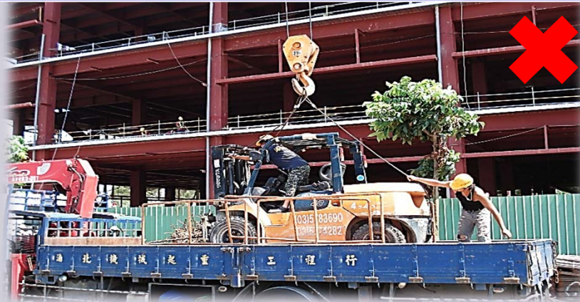
吊升堆高機等機械未使用吊裝平台
