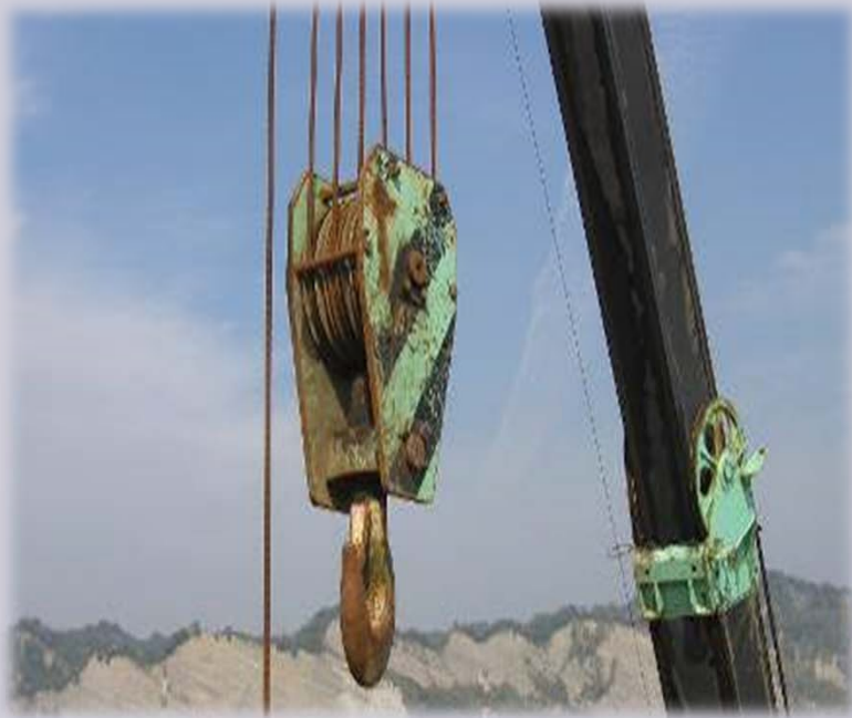
起重機具之吊鉤或吊具應有防止吊舉中所吊物體脫落裝置(防滑舌片)
