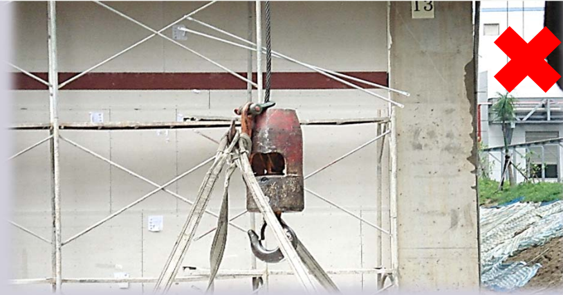
吊鉤鉤掛於吊鉤以外之位置
