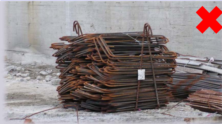
未採取散裝鋼筋於吊升中飛落危害
