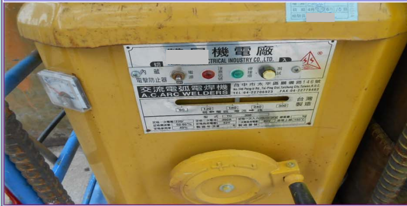
電焊機經防電擊裝置測試檢查張貼合格證
