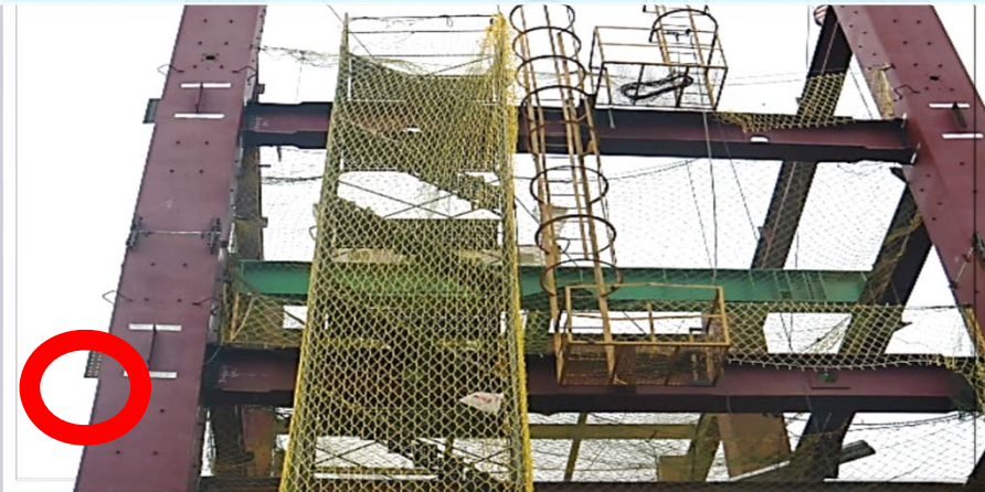
護籠梯加裝防墜器供人員安全上下鋼樑
