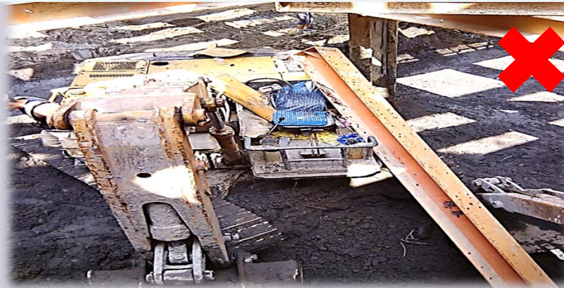
安全支撐之繫樑掉落在挖土機駕駛座上
