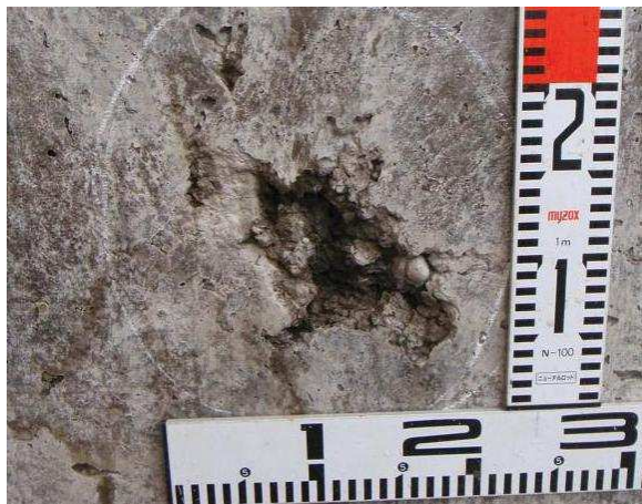
未充填箇所(豆板, ジャンカ) →締固め不足
