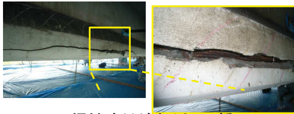
PC鋼材破断が生じたPC橋
