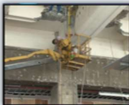
高空工作車壓夾職災現場
