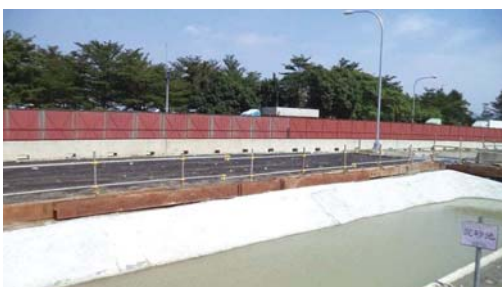
工區截流、沉砂系統
