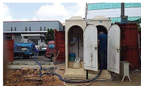
收集處理生活污水
