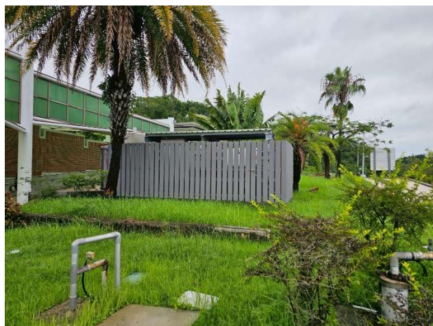
圖 4 南站配電場所
