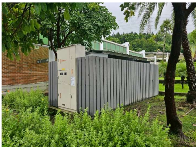
圖 3 北站配電場所
