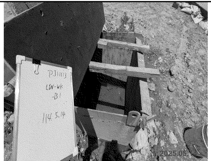
工區放流水 工區放流口 114.05.14
