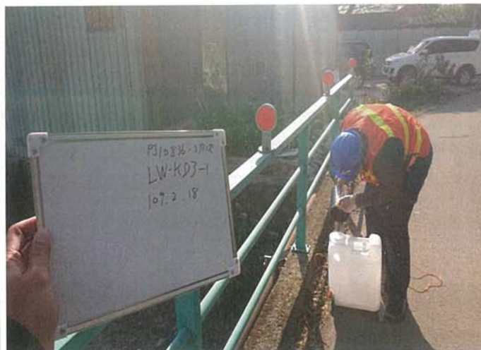
工區放流水監測站 工區放流口 109.02.18
