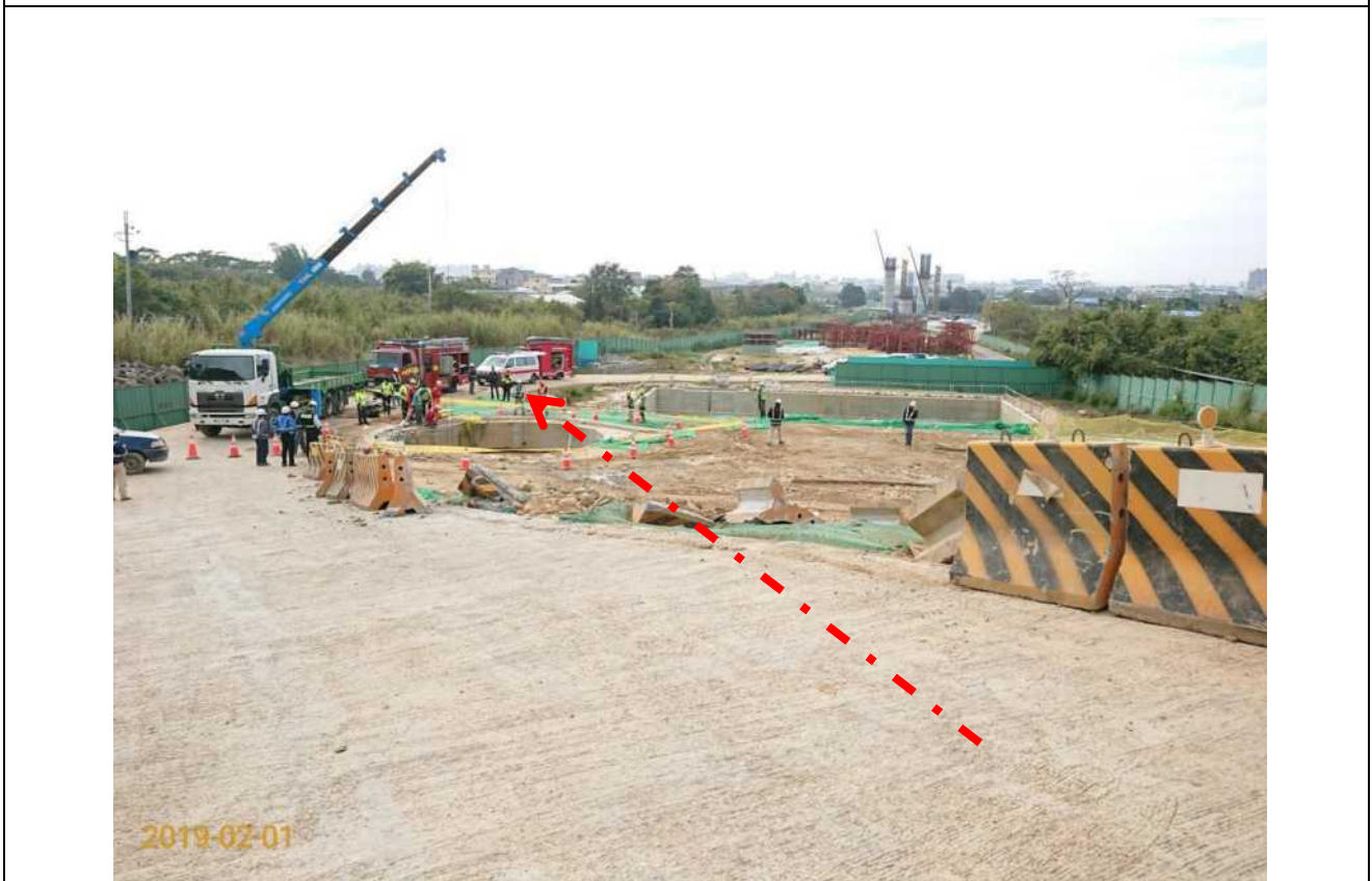
照片2：混凝土泵送車下滑撞倒施工便道 RC 護欄。
