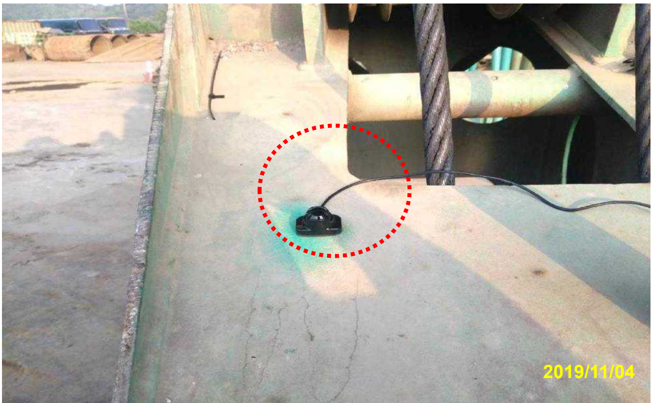
圖11、於吊臂上方裝設距離感測器警示操作人員 B
