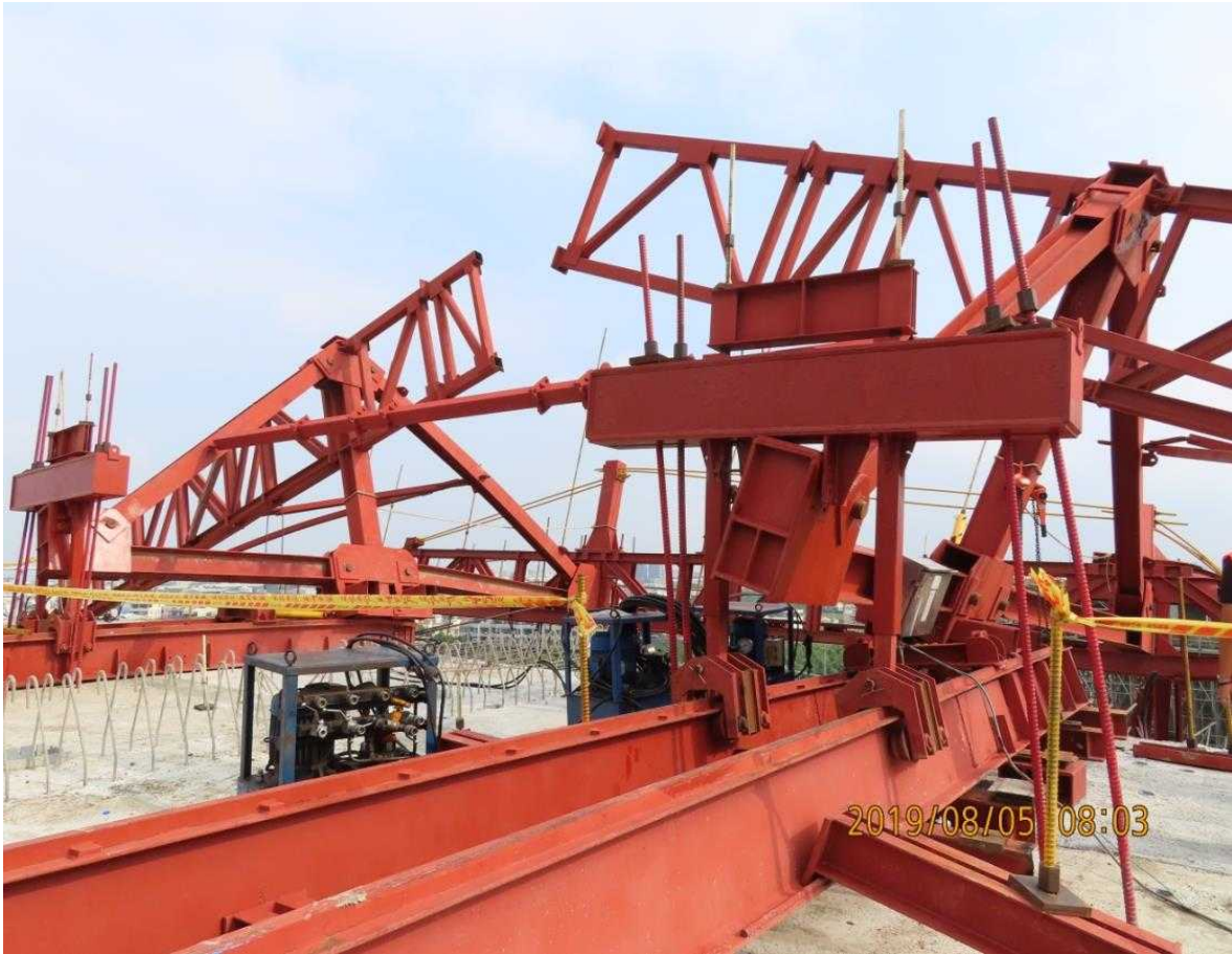
圖5、工作車兩端主 A 架受力不平均，北側後桁架突然脫落，造成倒塌
