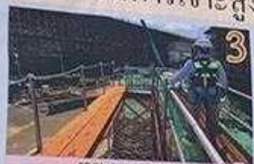
3 體驗高架作業平台 สัมผัสกับแพลตฟอร์มการเจาะสูงในระดับ
