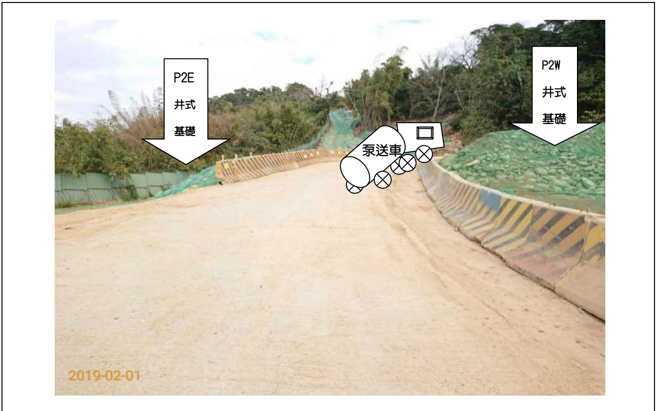
照片1：混凝土泵送車由施工便道移往 P2井基途中發生溜滑。
