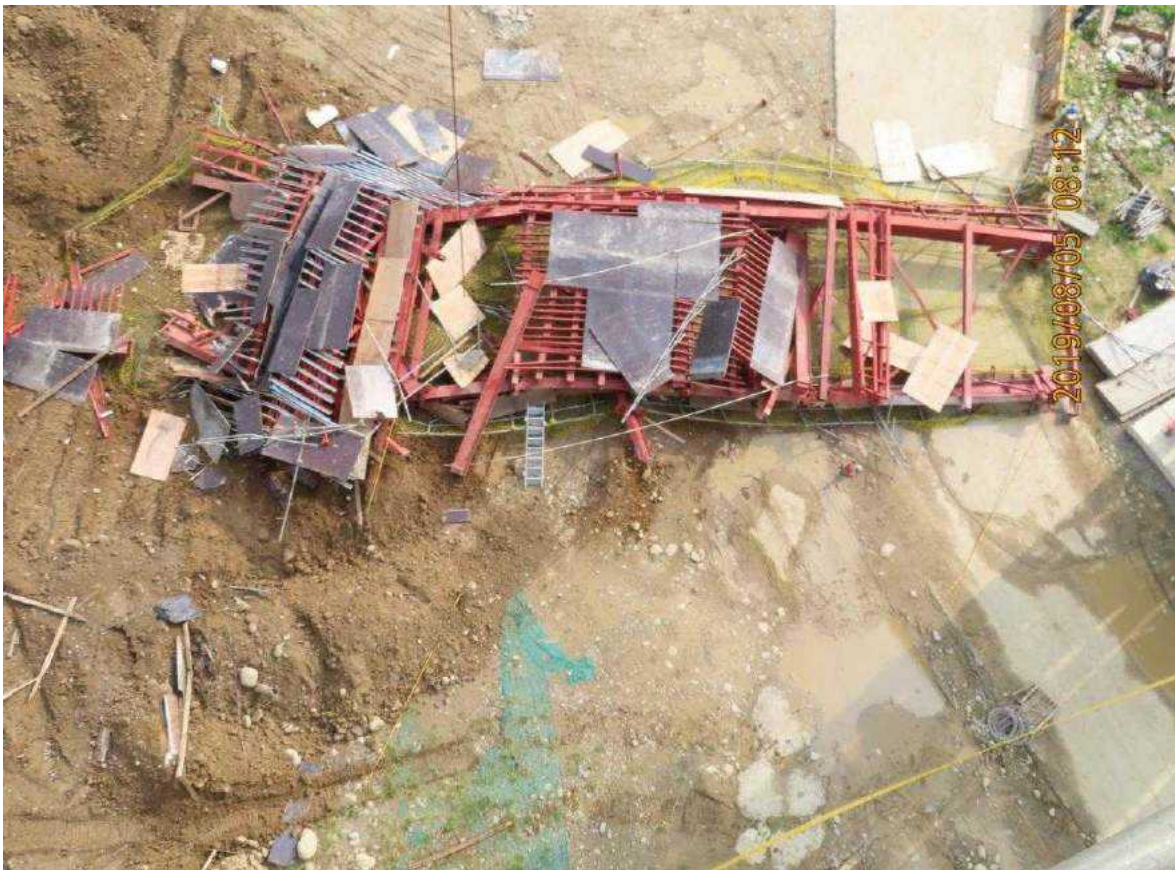
圖6、北側工作車底板墜落地面
