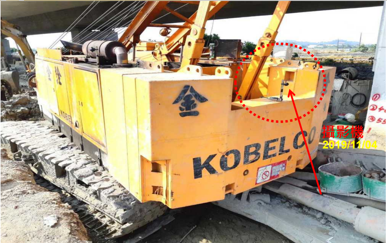
圖8、於吊車側邊及車尾操作人員無法通視位置裝設攝影機
