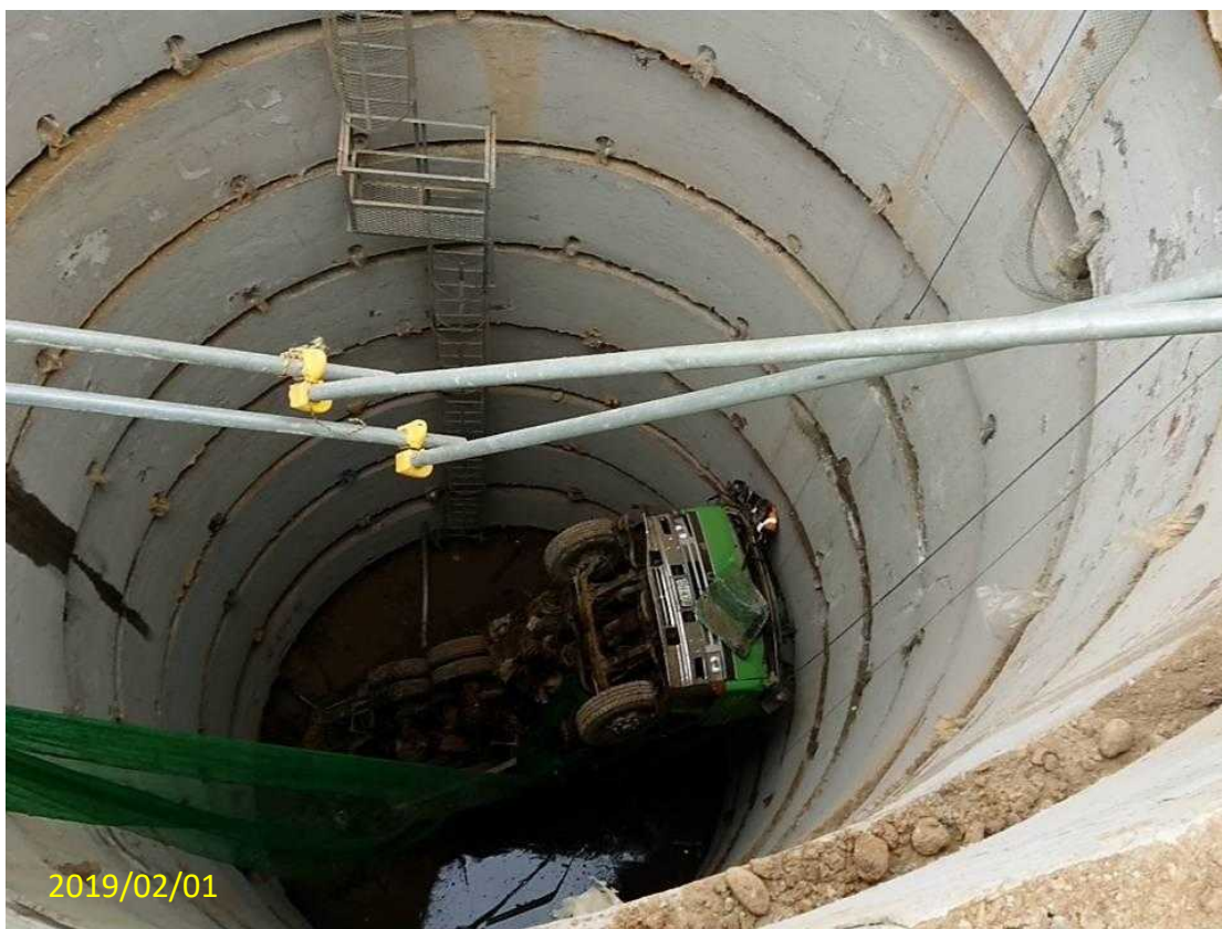
照片3:連人帶車掉入 P3W 井式基礎內，造成台籍勞工潘員及外籍勞工楚員受困於井式基礎內。
