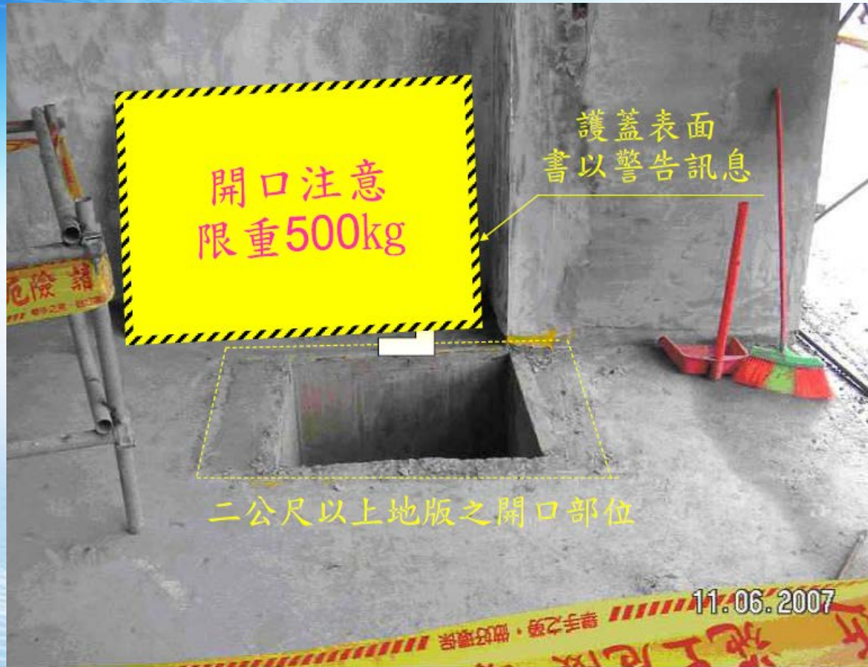
勞工自無護蓋防護之樓板開口墜落死亡
