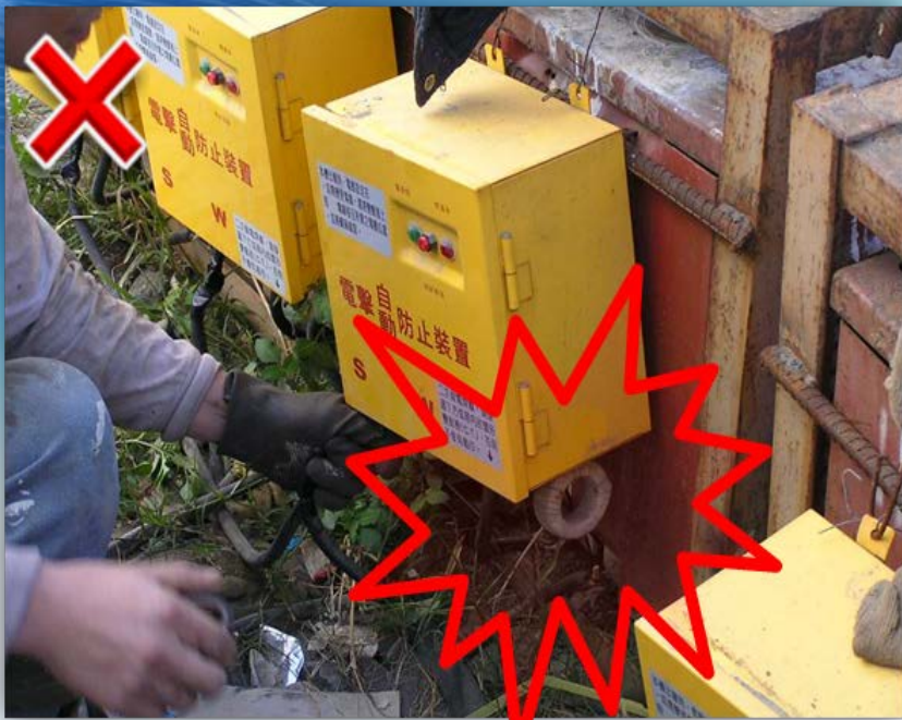
◎外掛式自動防電擊裝置線路未穿過比流器，造成功能失效。
