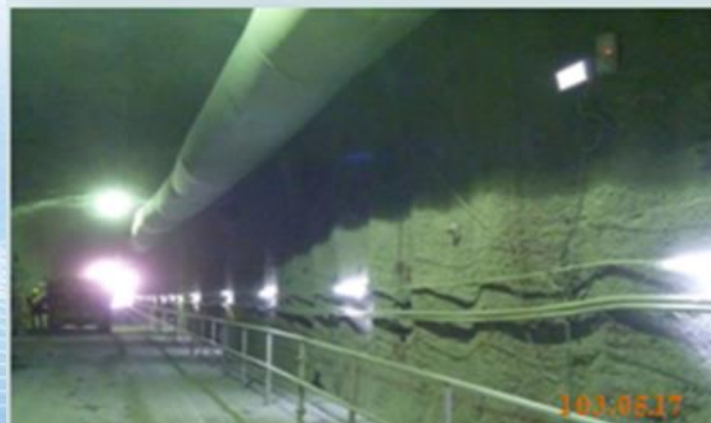
緊急照明、逃生指標燈、 照明設施
