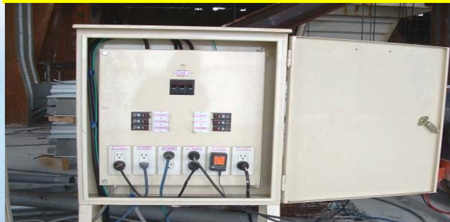
◎臨時用電所使用之配(分)電箱設置箱蓋、中隔板等防止人員誤觸帶電部分。
