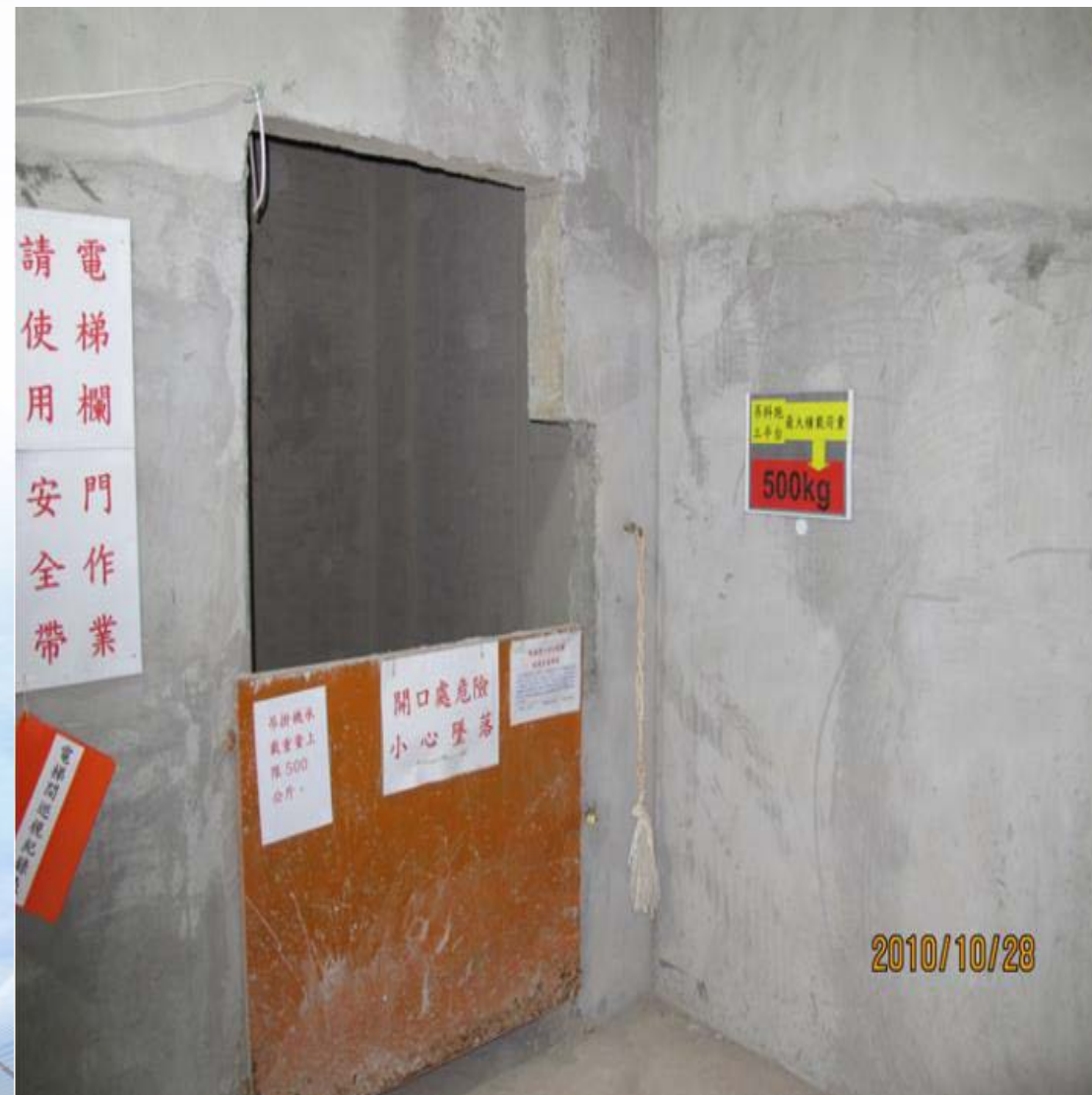
電梯直井吊料平台管制及荷重標示
