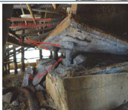
鋼柱接合處螺栓遭受破壞。
