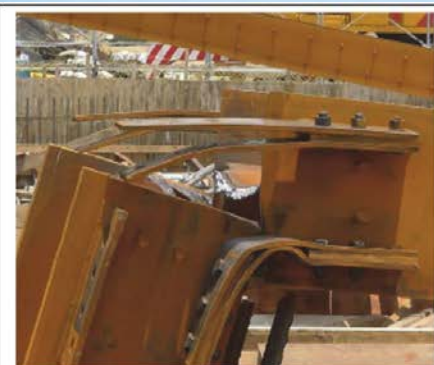
SRC 結構與鋼柱連結之螺栓已拔出。
