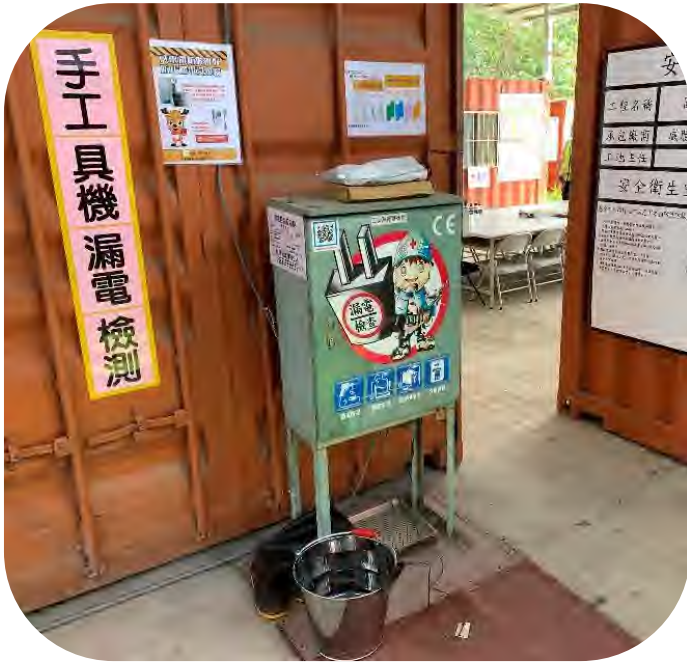
▲ 電動機具漏電檢測設備
