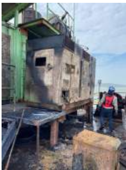
圖 1、發電機 (隔日拍攝)
