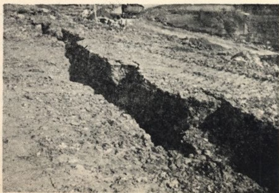
二號橋橋頭引道沉陷情形
