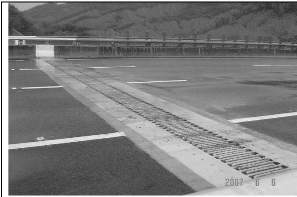
照片 3 A1 橋台齒型伸縮縫
