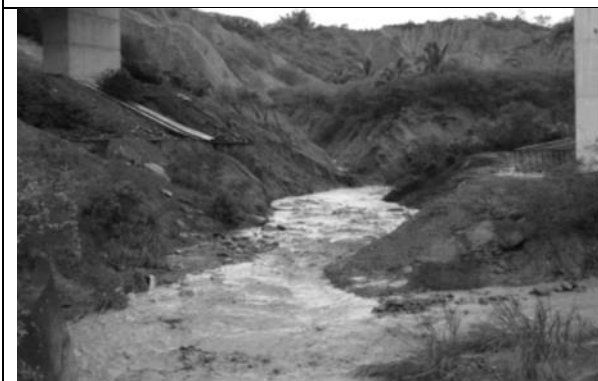
照片 7 原野溪冲刷橋台邊坡情況
