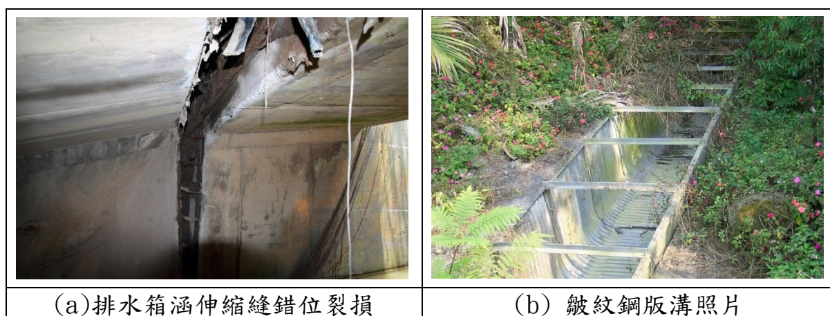
圖 4.5-5 斷層變形帶排水設施破壞及改善工法照片
