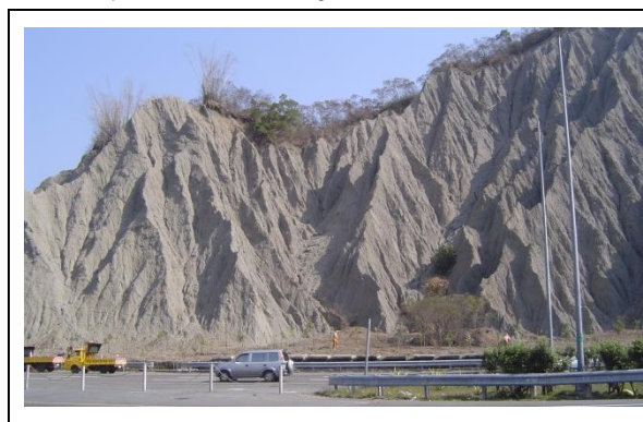
圖 4.5-2 泥岩邊坡與沖蝕溝
