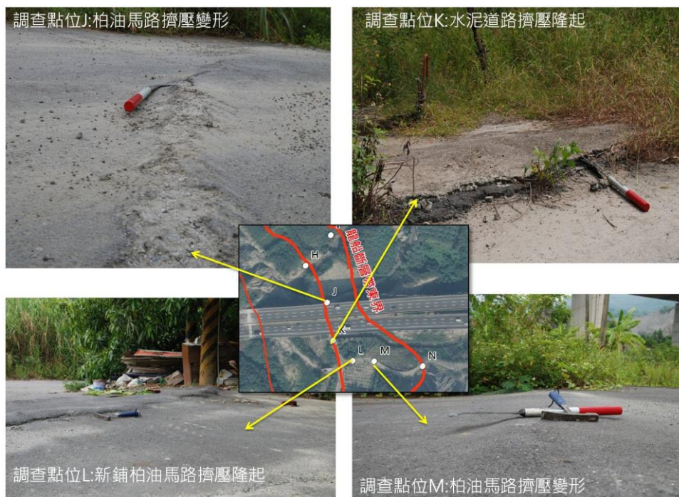
圖 5.4-2 橋下產業道路受擠壓變形龜裂情況
