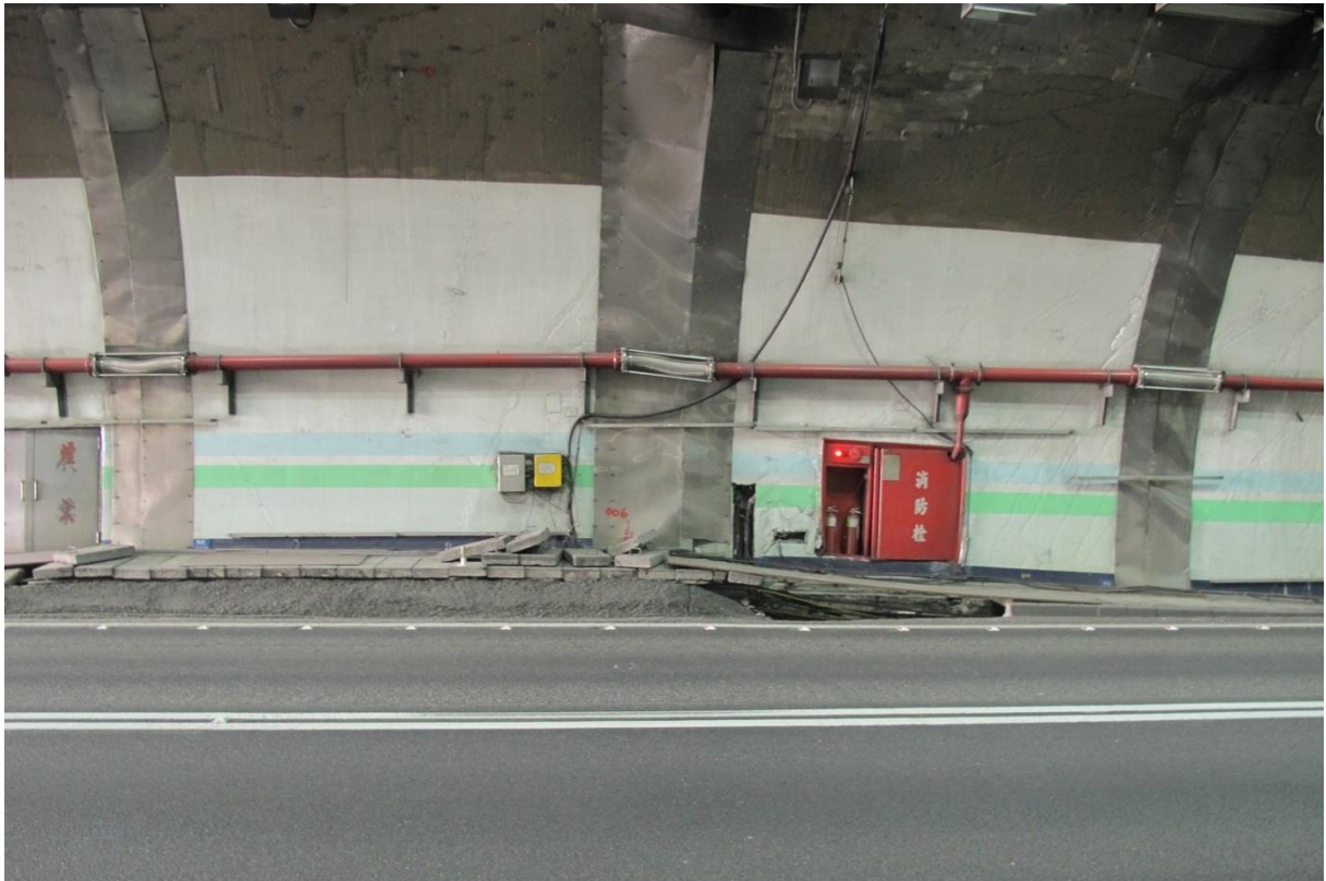
圖 4.4-5 中寮隧道北洞口抬升與側壁龜裂情形
