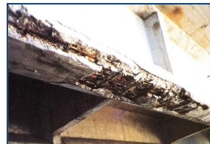
混凝土結構腐蝕
